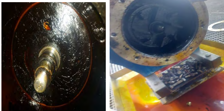
Gambar 4.4 Kondisi Casing Volute Setelah menggunakan Y-Strainer .
