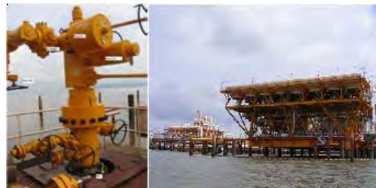
Gambar 2. Kepala Sumur dan Kompresor
