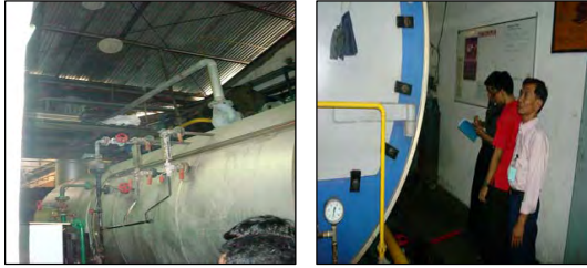
Gambar 3. Boiler di Industri Karpet
