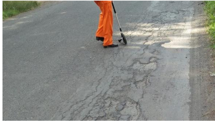
Gambar 2. 8 Retak Pinggir ( Edge Cracking )
