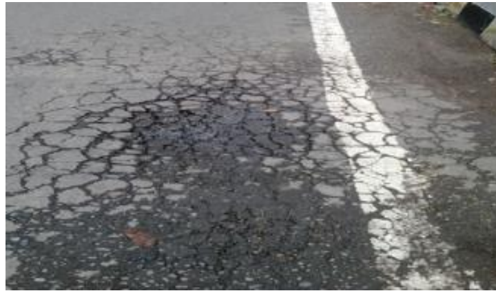
Gambar 2. 2 Retak Kulit Buaya ( Alligator Cracking )
