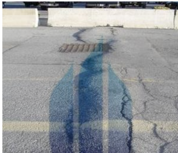
Gambar 2. 5 Retak Cekungan ( Bumb and Sags )
