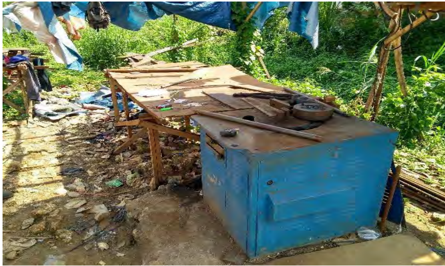
Gambar 4.10 – Bar Bender Sumber : Proyek, 2018
