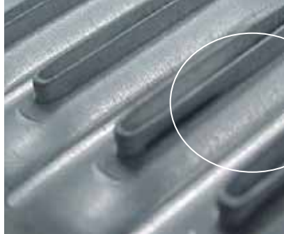
Gambar 4.9. Kebocoran Karena Brazing Tidak Matang
