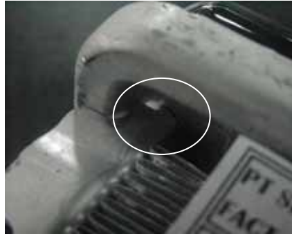
Gambar 4.11. Bocor Karena Ada Lubang Antara SP dan HP
