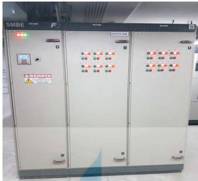
Gambar 2.2. Panel Capasitor Bank Hotel Ibis Styles Tanah Abang Gambar di atas adalah Panel Capasitor Bank dengan kondisi pintu panel dalam keadaan tertutup.
