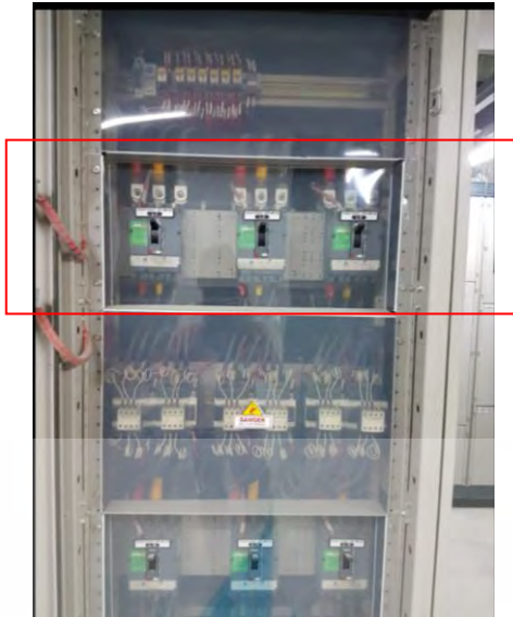
Gambar 2.6. Main Switch di Panel Capasitor Bank
