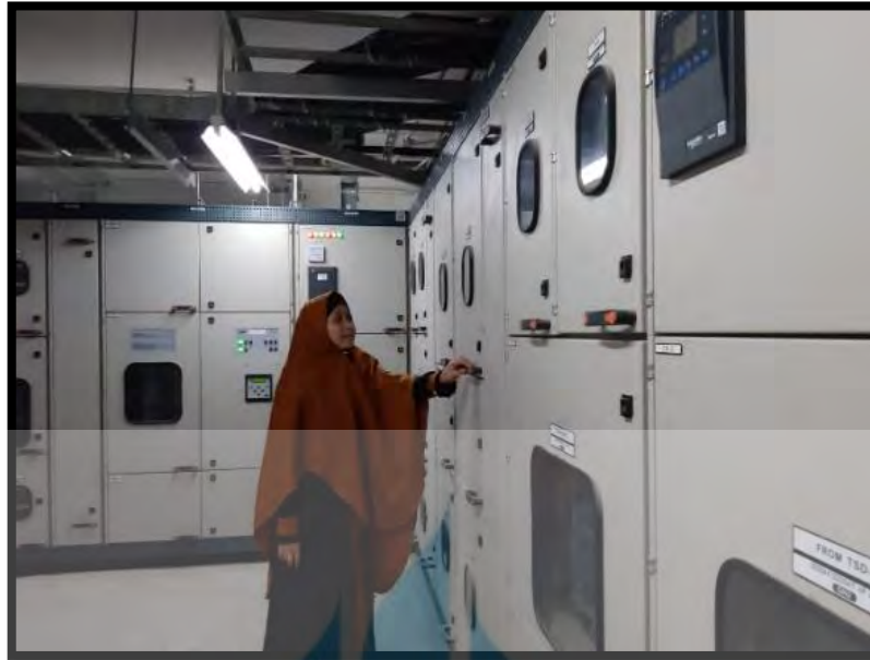
Gambar 2.1. Panel Utama Tegangan Rendah
