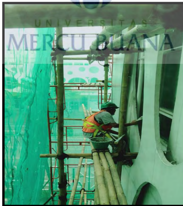
Gambar 4.2 Scaffolding Tidak Standard
