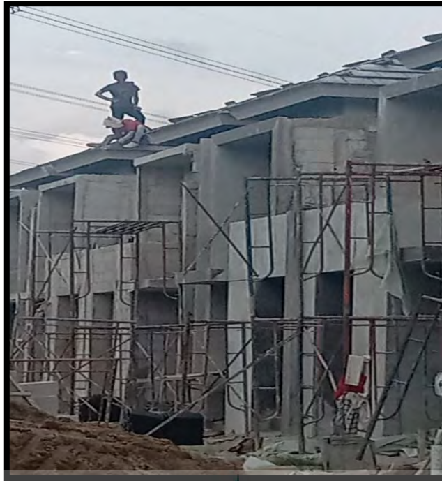
Gambar 4.3 Tidak Menggunakan APD
