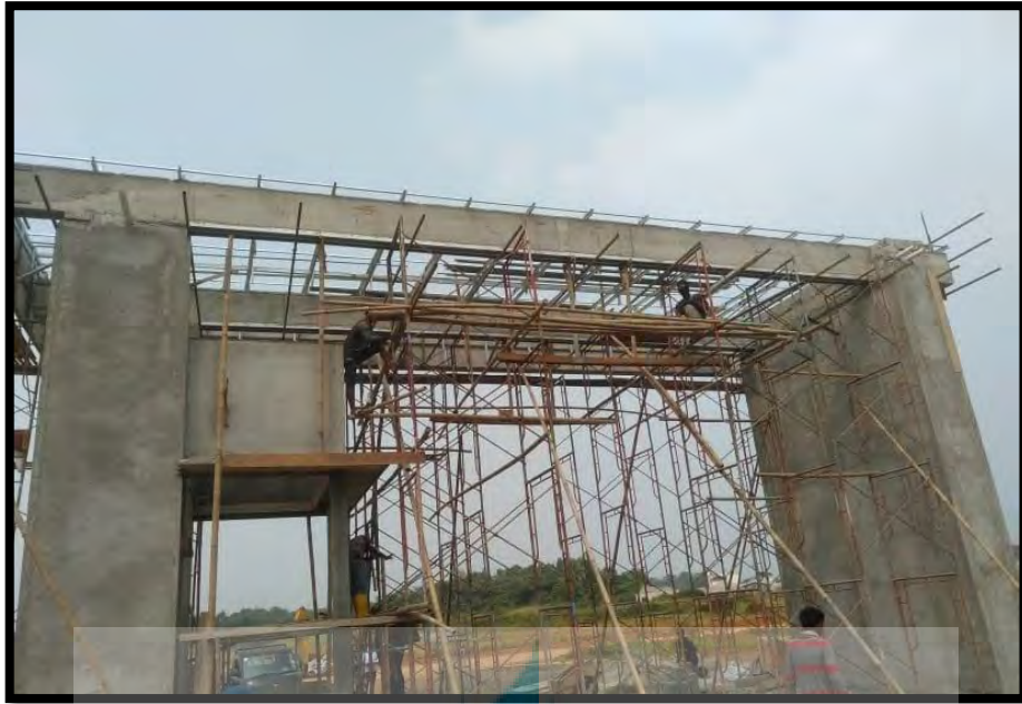
Gambar 4.1 Pelanggaran HSE Bekerja di Ketinggian
