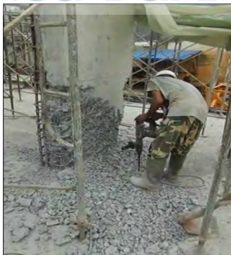
Gambar 7.4 Pengecoran kolom yang bunting
