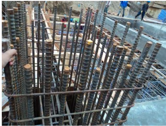
Gambar 5. 11 Sisa tulangan kolom dari pemasangan dilantai dibawahnya
