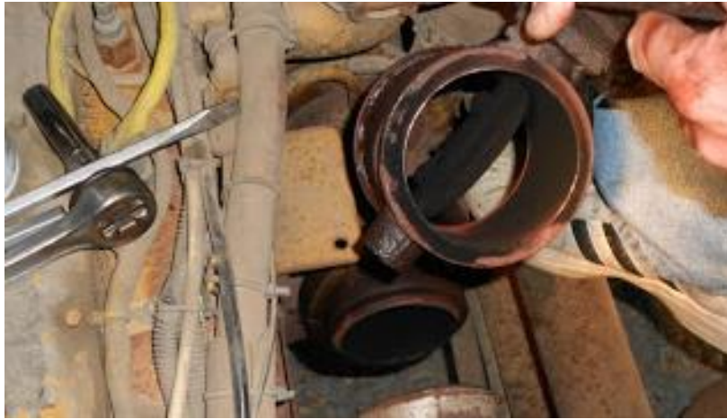
Gambar 4.9 Kondisi Butterfly Valve (Sumber: dokumen pribadi)
