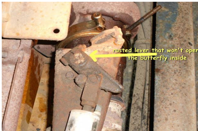
Gambar 4.2 Piston Pneumatic tidak mendorong Butterfly Valve (macet) pada posisi Exhaust Brake Switch “ON”.
