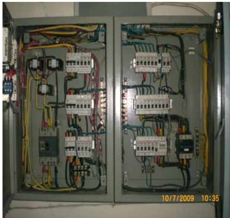
Gambar 6.13 Panel power dan penerangan L5G1
