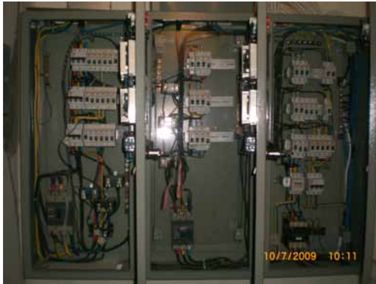
Gambar 6.10 Panel power dan penerangan L2G1
