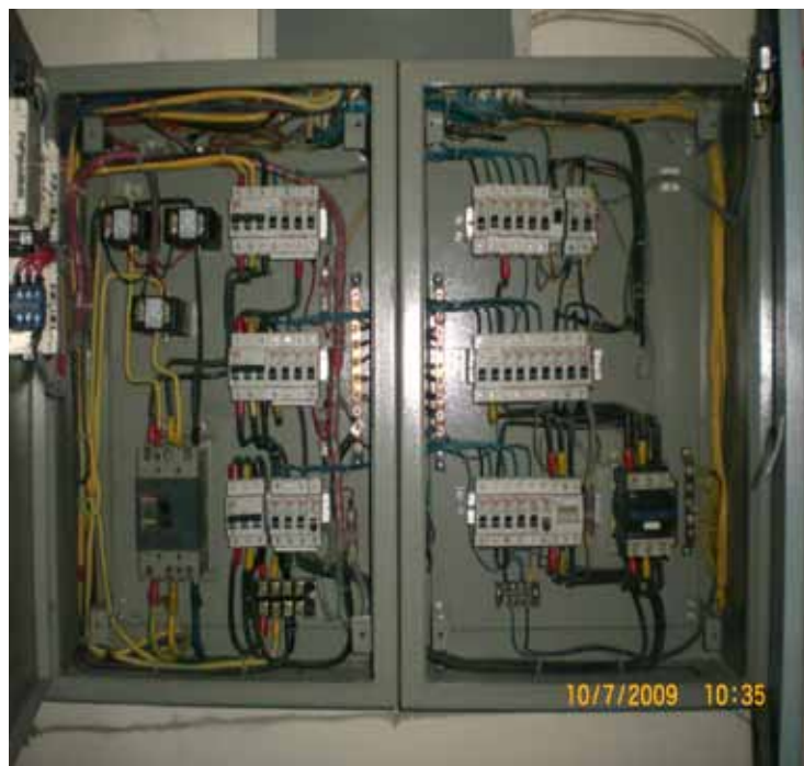
Gambar 6.15 Panel power dan penerangan L7G1
