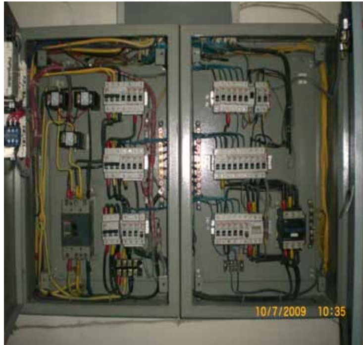
Gambar 6.14 Panel power dan penerangan L6G1
