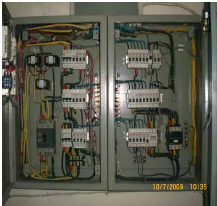
Gambar 6.11 Panel power dan penerangan L3G1
