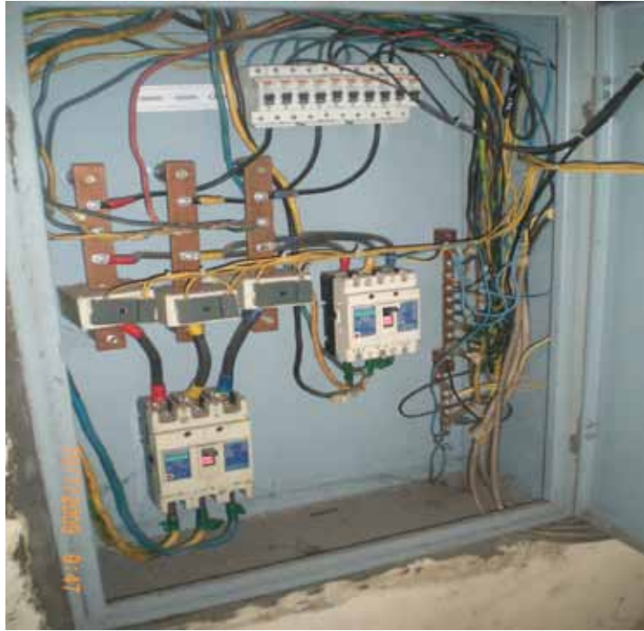
Gambar 6.30 Panel power dan penerangan ruang makan karyawan L1G2
