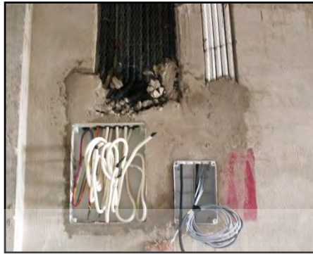
Gambar: Pipa instalasi listrik (hitam) dan pipa instalasi elektronik (putih).
