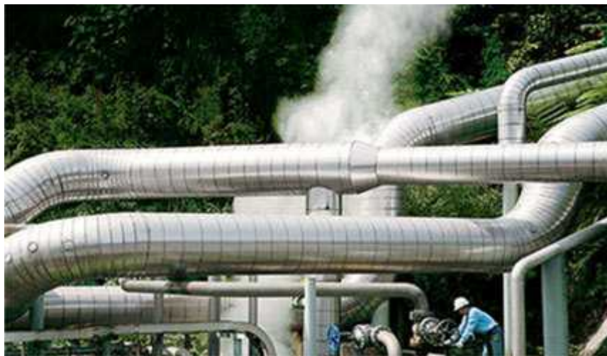
Gambar 5.2 Pipa Brine Insulasi dari Calcium Carbonat dan Pembungkus Aluminium.
