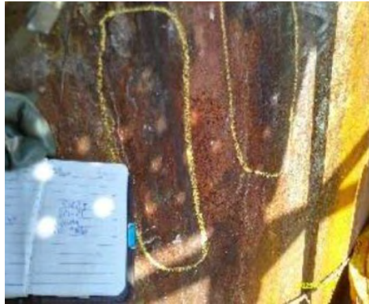
Gambar 3.5 Kondisi Shell 1-01 Menunjukkan Indikasi Kerusakan
