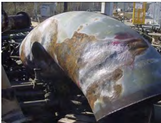
Gambar 2.12 Korosi Dibawah Insulasi
